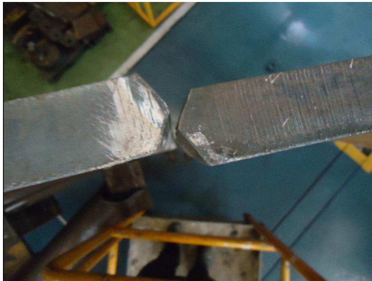
Figura 19 - Desalinhamento entre os setores das virolas
