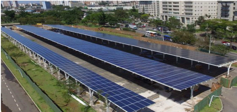
Figura 2 – Painéis Fotovoltaicos (FV) cobrem o estacionamento no parque
