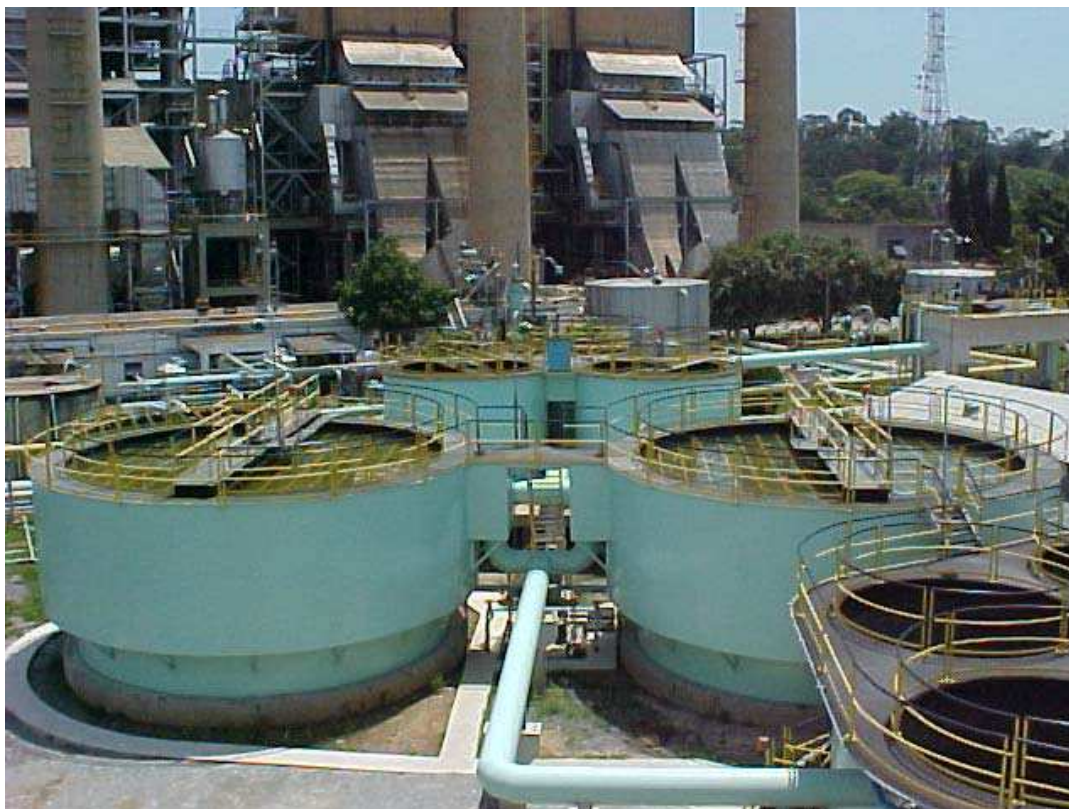
Figura 4 – Estação de Tratamento de Água de Pedreira
