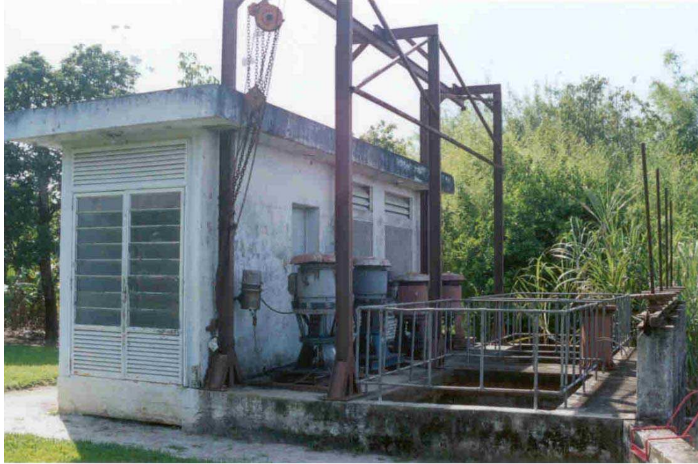
Figura 12 – Captação de água
