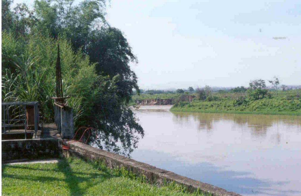
Figura 10 – Erosão no Rio Paraíba do Sul
