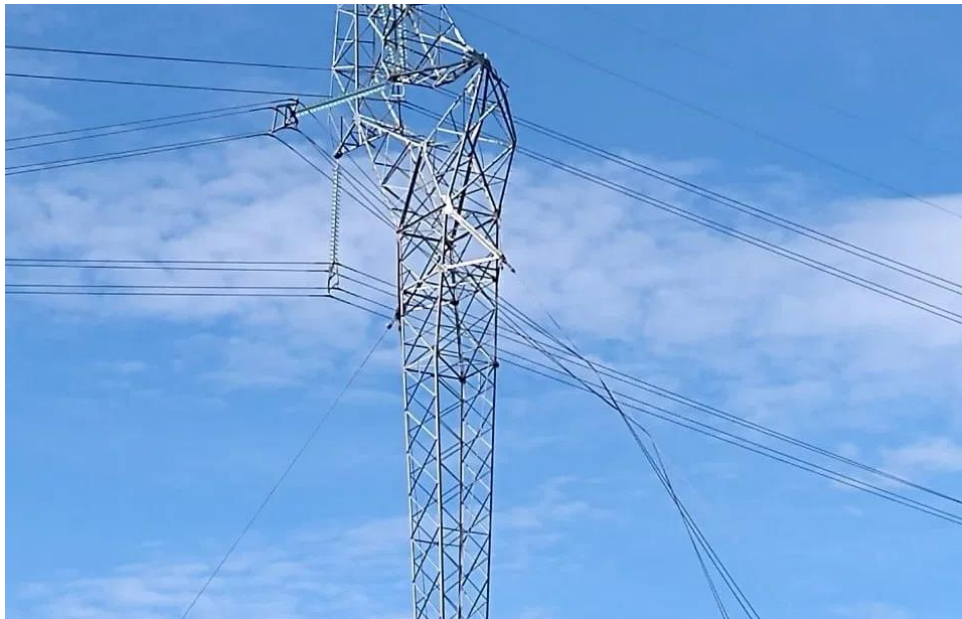
Figura 9 – Cabo Condutor Rompido
