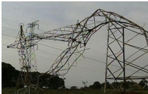
Figura 27 – Torre Colapsada, Candido Mota – SP (2012)
