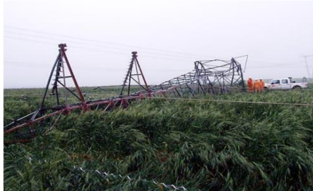
Figura 28 – Torre Colapsada, Cascável – PR (2013)
