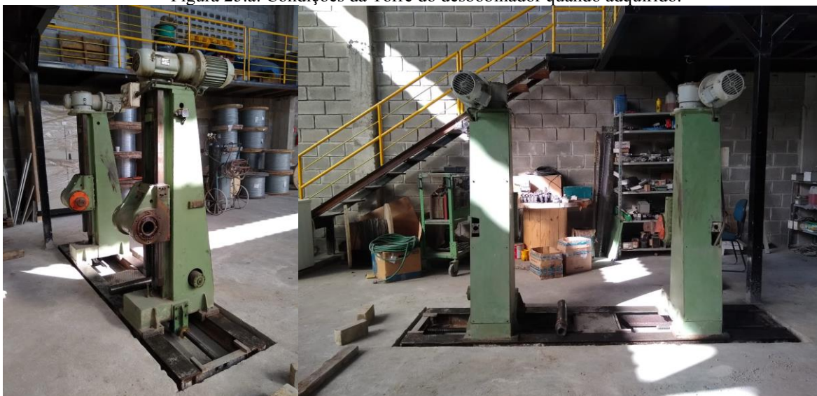
Figura 25.a: Condições da Torre do desbobinador quando adquirido.
