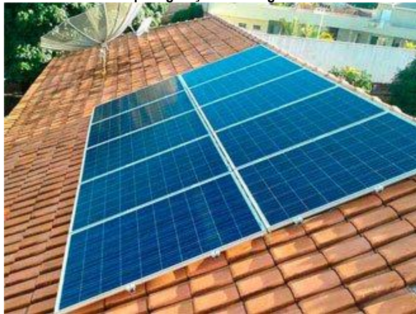
Figura 3 - Painel fotovoltaico para geração de energia instalada em uma residência.
