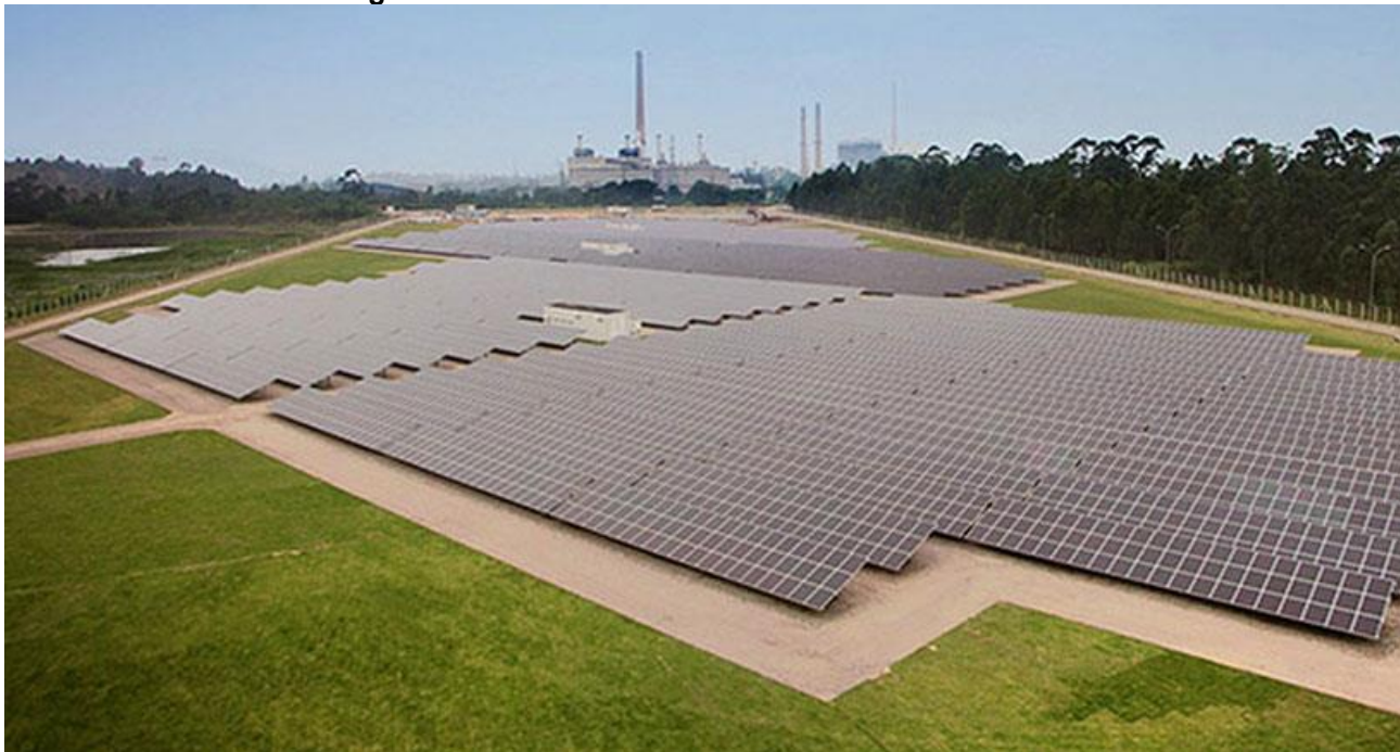
Figura 4 - Usina solar fotovoltaica.
