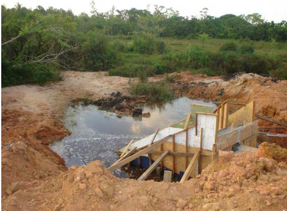
Figura 23 – Obra de desvio de emissário com assoreamento na Área de Proteção Ambiental do Banhado de São José dos Campos.
