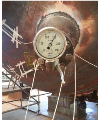
Figura 38: Flange com manômetro
