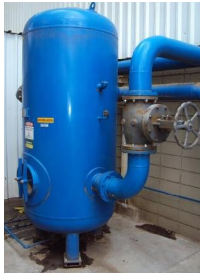
Figura 7: Tubulação ligada à conexão
