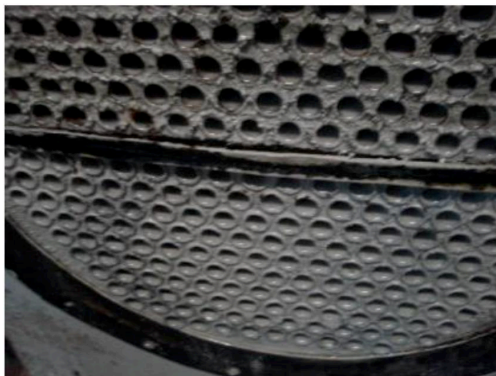
Figura 8 - Incrustação de carbonatos
