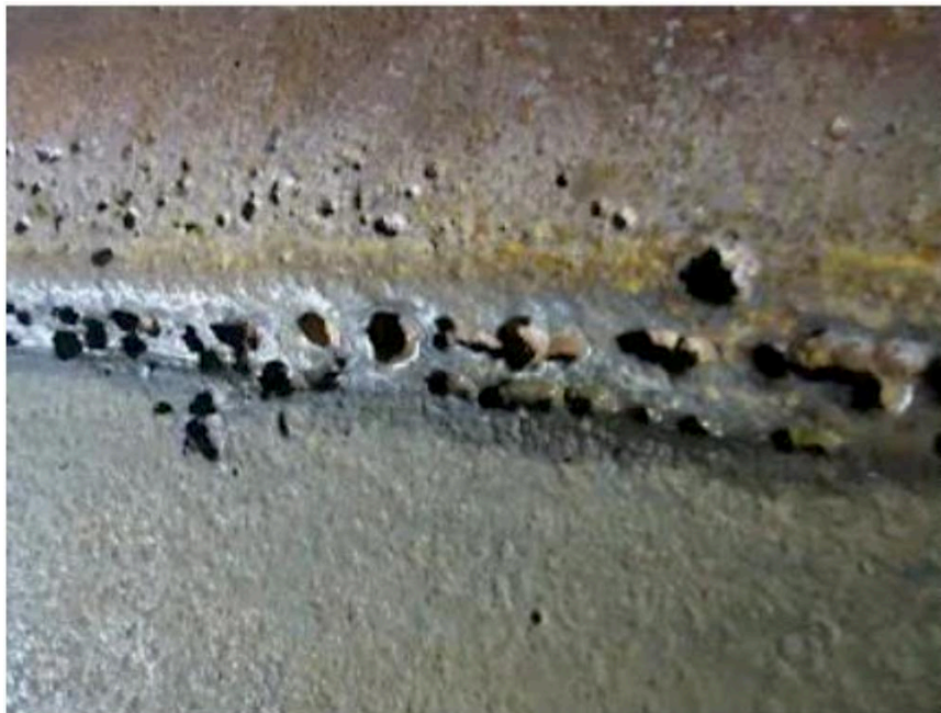
Figura 1 – Corrosão por Pites
