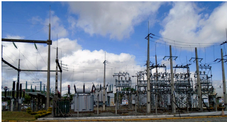
Figura 5 - Subestação de energia elétrica de 88kV
