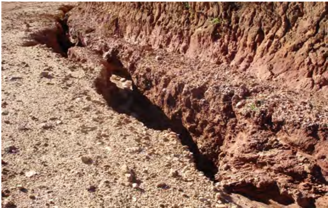
Figura 42: Erosão na beira da estrada – Estrada dos Tropeiros – Silveiras-SP Foto: idem, ibidem.2006.
