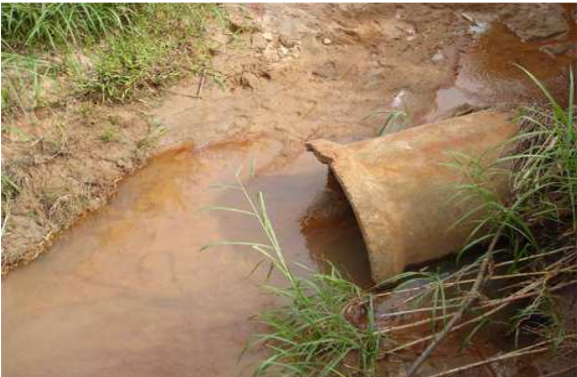
Figura 44: Descarga de efluentes – Cunha-SP
