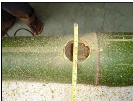
Figura 21. Perfuração do colmo (bambu estrutural). O espaço aberto servirá de passagem das mudas de B. multiplex
