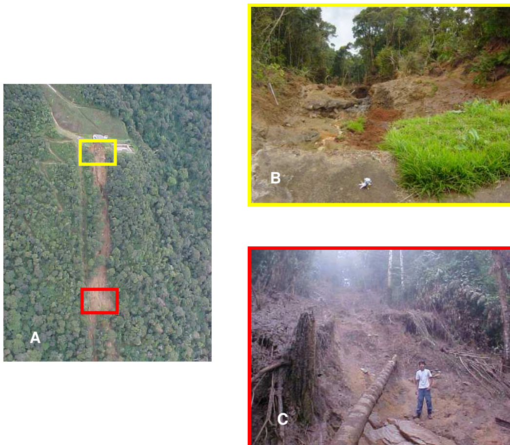
Figura 13. Imagem A: vista geral da área após o acidente, destacando dois pontos ilustrados nas imagens B e C. Em amarelo, o ponto do rompimento da tubulação em detalhe na imagem B; em vermelho, destaque da região de dissipação de material, evidenciado na imagem C
