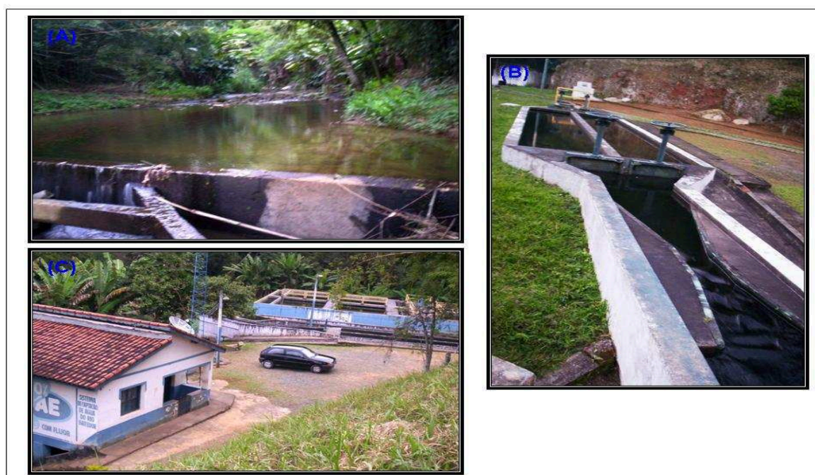
Figura 19 :Aspecto da captação de água na bacia do batedor (Foto do Autor)
